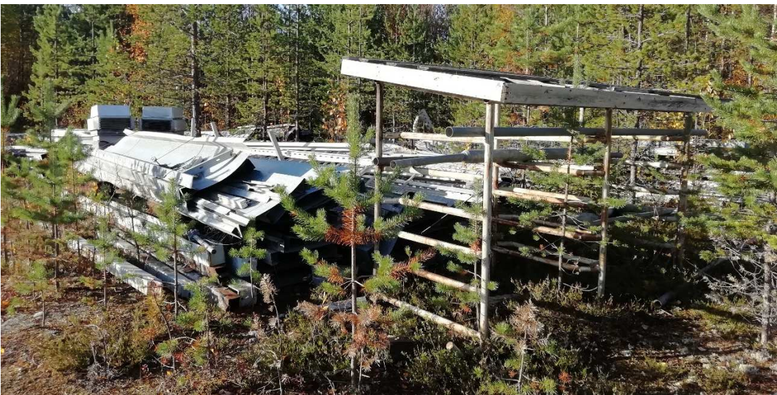
Kuva 8. Teollisuushallin osia, jotka on määrätty poistettavaksi 31.12.2021 mennessä.
