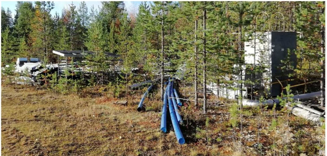
(Kuva 2. Jätteitä, jotka on määrätty poistettavaksi alueelta 31.8.2021 mennessä.) Kuvassa uutta käyttämätöntä paineputkea, sähköpääkeskus, rosteri putkea, suojakaide, rautateline ja hallin seinä peltejä. Mikään näistä ei ole jätettä.
