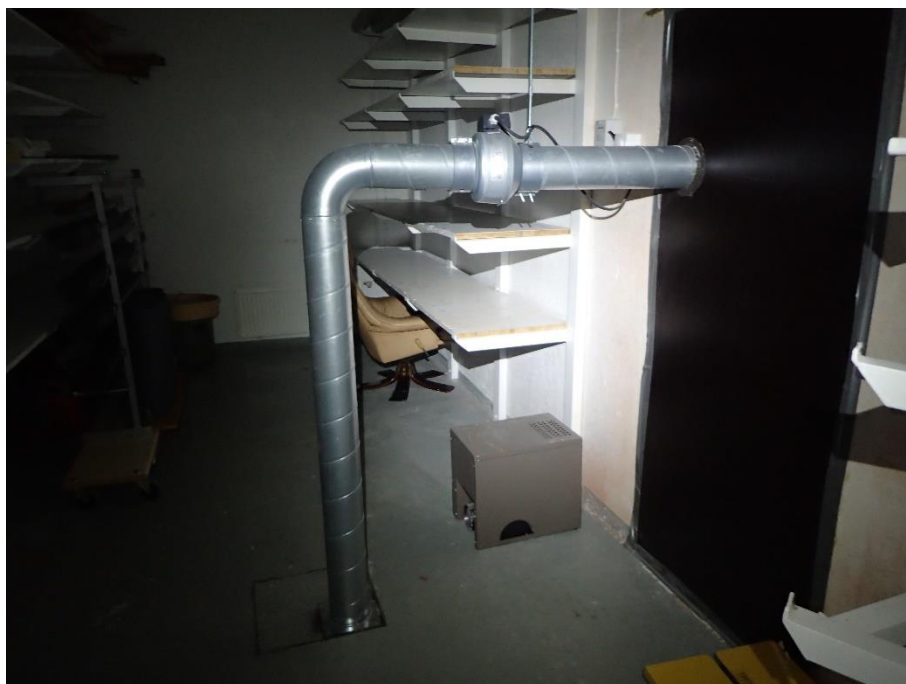
Kuva 1. Kanaalista tuleva kanava, jossa kanavapuhallin.
