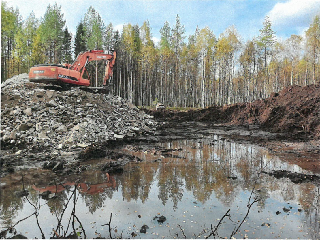
Kuva 2. Auki kaivetulle alueelle oli lammikoitunut vettä.
